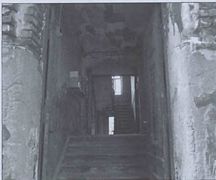
Fot. 5. Wnętrze zdewastowanej kamienicy przy ul. Sikorskiego (fot. J. Jachowska)
